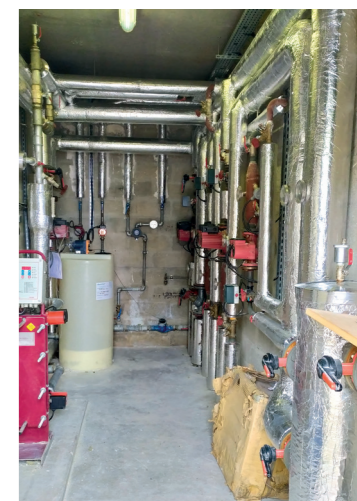
Sous station de l'école maternelle
