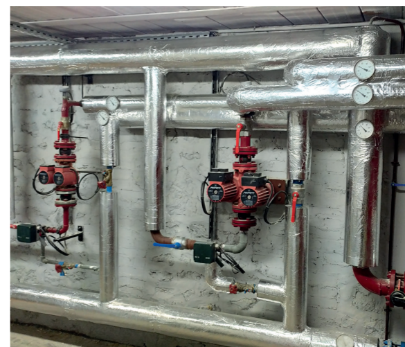
Sous station de l'école élémentaire
