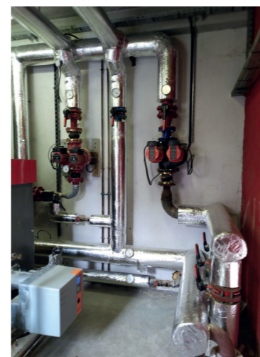
Chaufferie du groupe scolaire A.CHEVRIER
